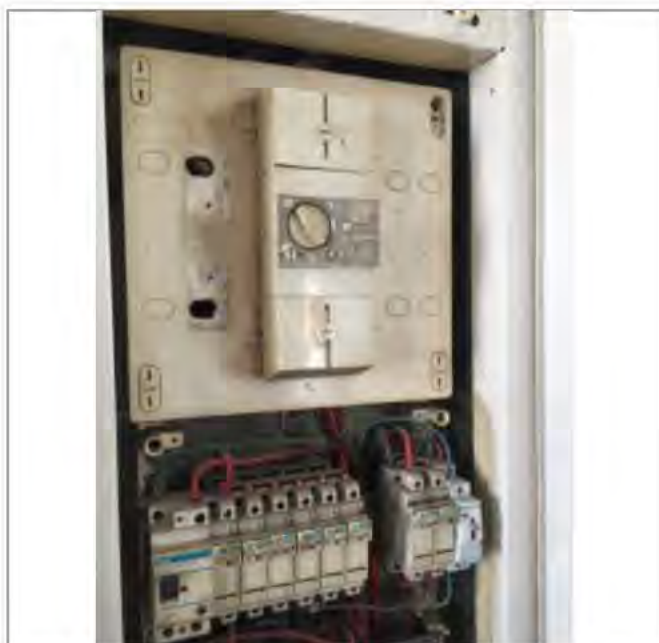
Appareil général de commande et de protection réglé à 45A non alimenté
