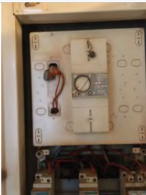
Appareil général de commande et de protection réglé à 45A
