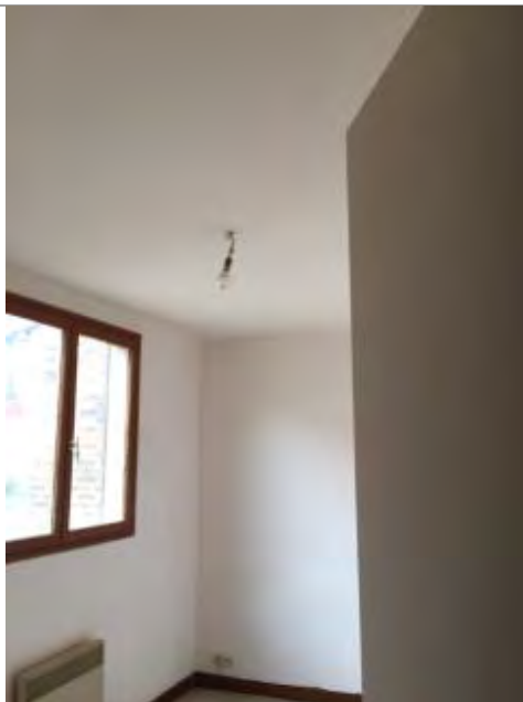
Douille de chantier , domino accessible ( non admis)
