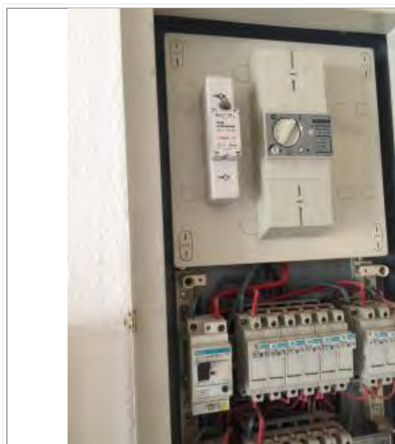
Appareil général de commande et de protection réglé à 30A non alimenté
